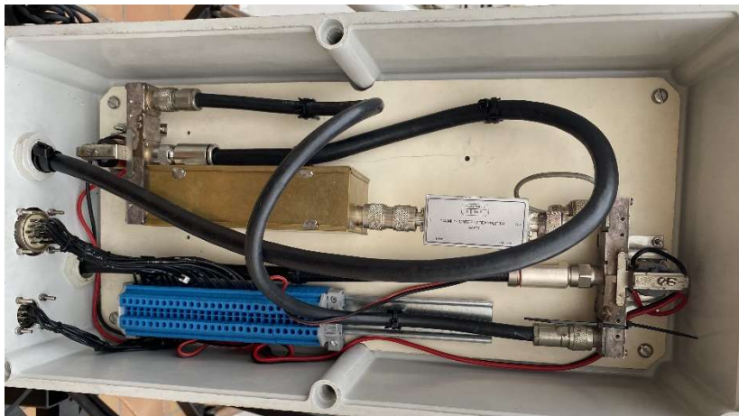
Ilustración 26. Vista interna de la caja estanca con el preamplificador de mástil y los relés de conmutación utilizados por el autor en su estación durante muchos años.
